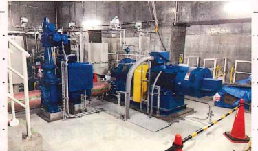
R5 ポンプ設置の三美機場
