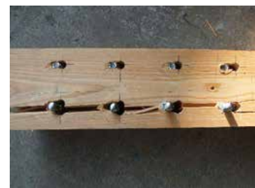
木材の割裂破壊+ボルトの破断
