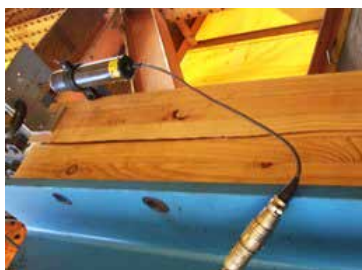
木材の割裂破壊
