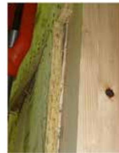
釘の引き抜けと柱の割裂（同）
