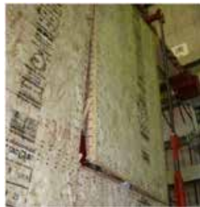
間柱と胴つなぎが割裂して面外に孕んだ OSB（同）
