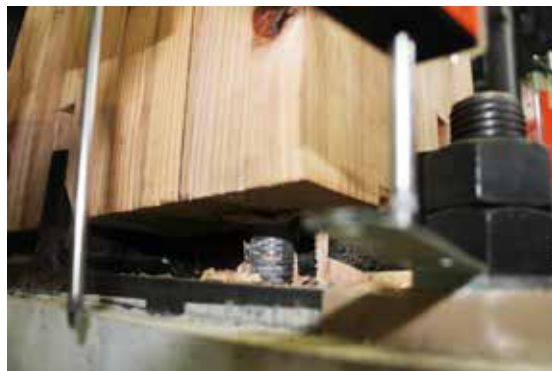
接合金物の破断
