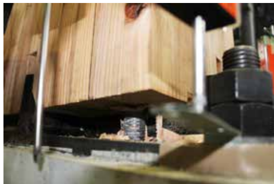
接合金物の破断
