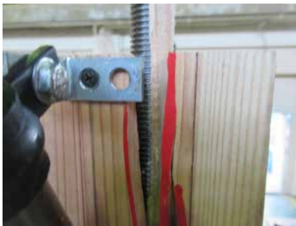
写真 1 GIR 引き抜けによる周辺部材の破壊
