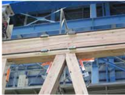
1/50rad 負側加力時 ブレース引き下げによる桁破壊
