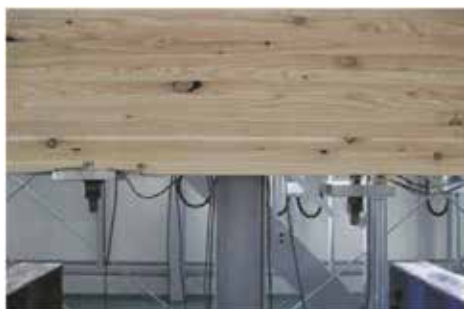
柱座金の柱側面へのめり込み
