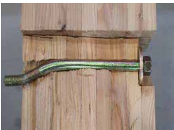
ボルトの曲げ降伏後
