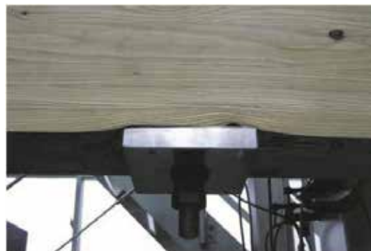
柱座金の柱側面へのめり込み
