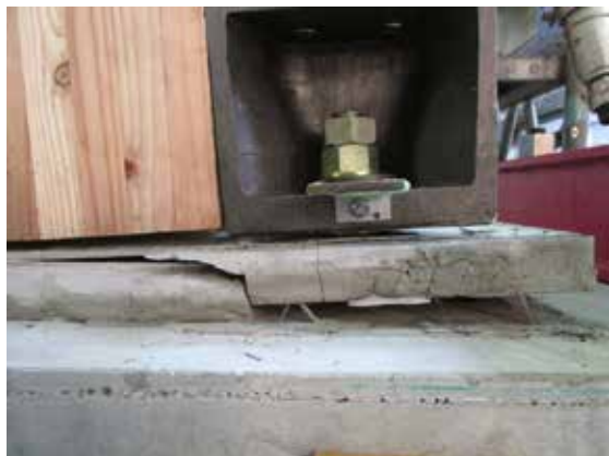
アンカーボルトの伸び
