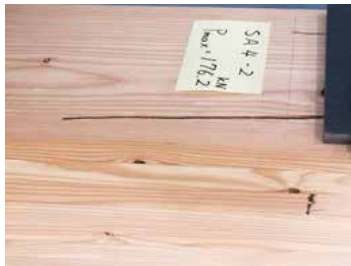
木材の割裂破壊
