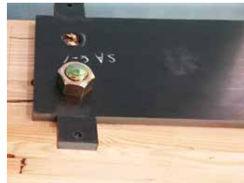
ボルトの破断
