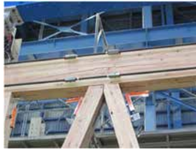
1/50rad 負側加力時 ブレース引き下げによる桁破壊
