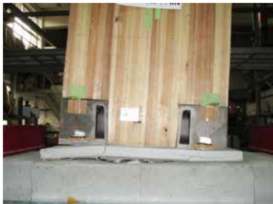
ベースモルタルのひび割れ
