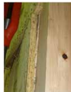
釘の引き抜けと柱の割裂（同）
