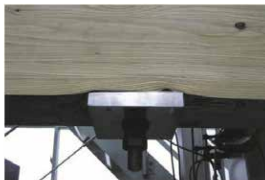
柱座金の柱側面へのめり込み
