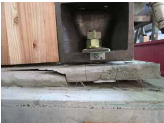
アンカーボルトの伸び
