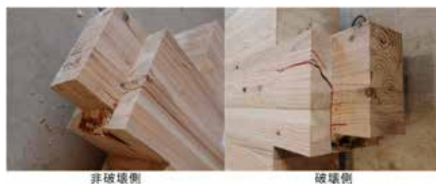
試験終了後の梁端部 No.2
