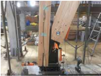
最大変形時のブレース端部
