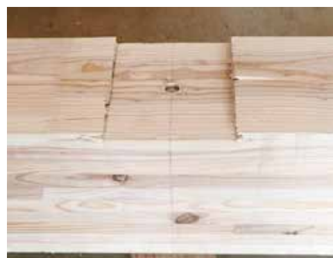
鋼板のめり込み
