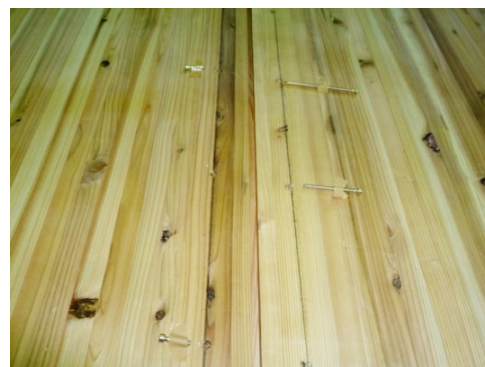
斜め打ちのビスは破断したのも多く見られた
