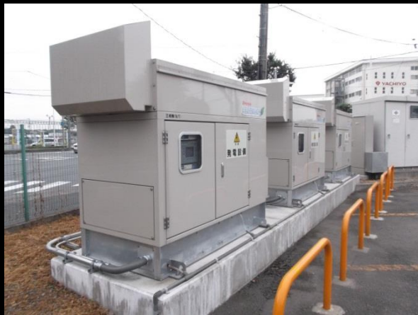
▲ (非常用LPガス発電機)
